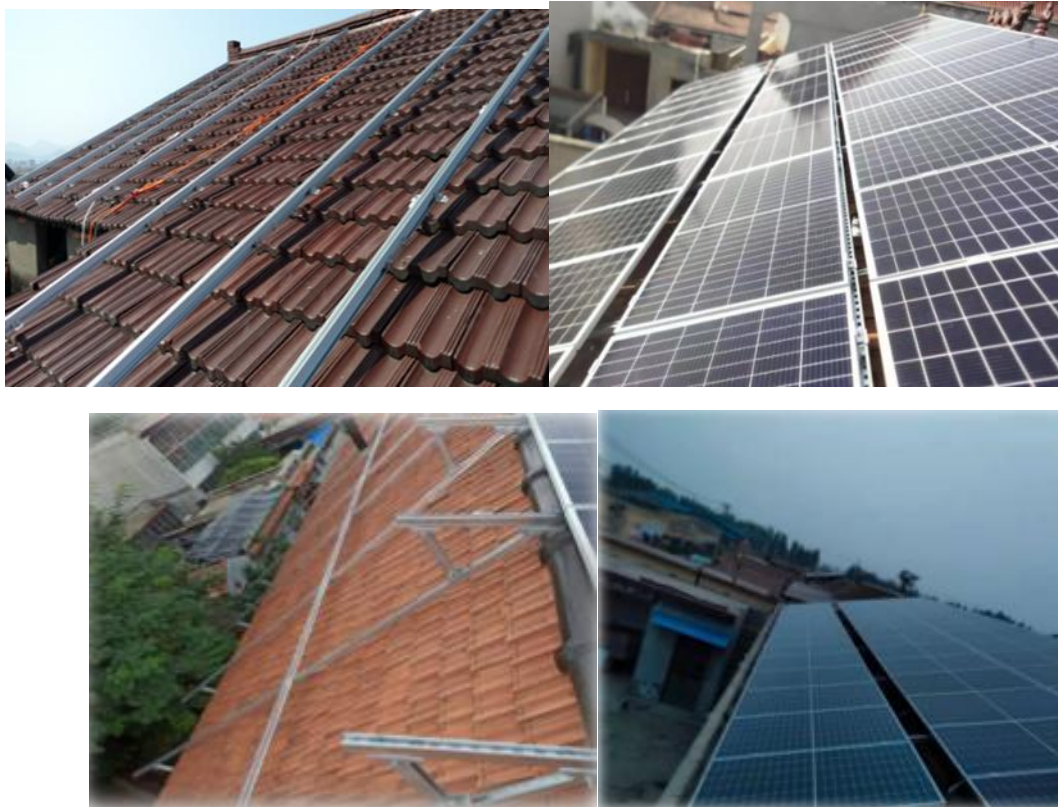
斜屋面户用分布式光伏系统照片
